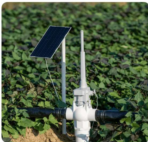
太阳能电源供电 2
